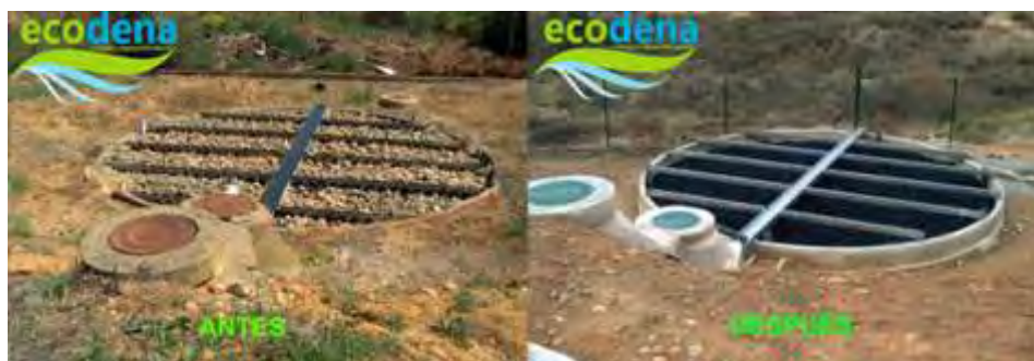
Ejemplo de reforma de filtro biológico obsoleto en León
