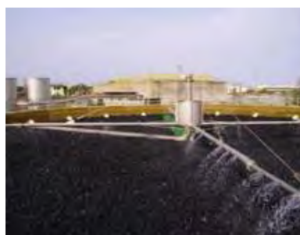
Filtro percolador para 30.000 Habitantes
